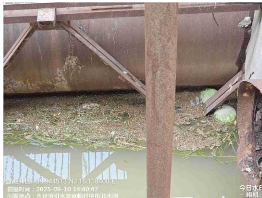
三家店调节池（门头沟段：铁道桥下河岸有废弃物 T14:12）
