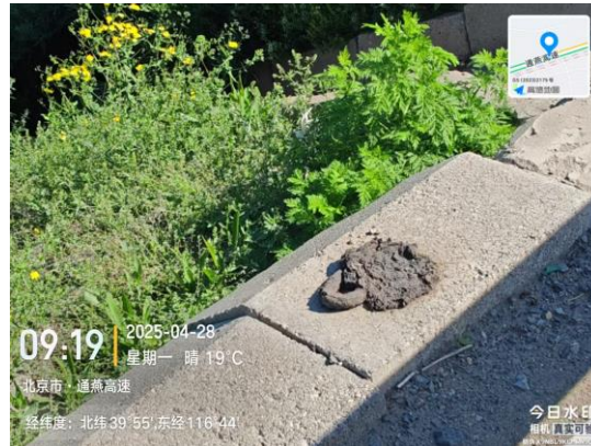
京通快速路出京方向<国贸桥-八里桥收费站>（通州段：13.3-13.5 隔离带有废弃物 T13:12）
