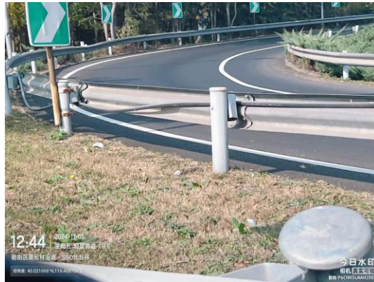
海淀段：88.7 公里处道路遗撒未及时清理 T12:55//丰台段：6 2.8 公里处隔离带有废弃物 T13:25)
