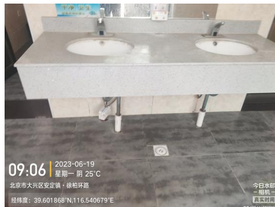
徐柏村西路口公厕（未配备有效的消防器材 T09:06）
