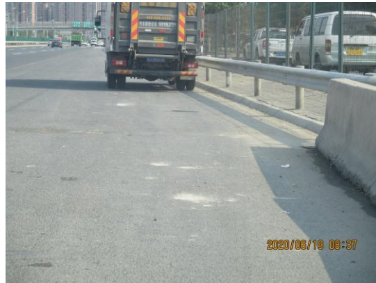
机场第二高速进京方向<T3 航站楼-平房桥> (顺义段: 11.5公里处护坡有废弃物 T8:51)
