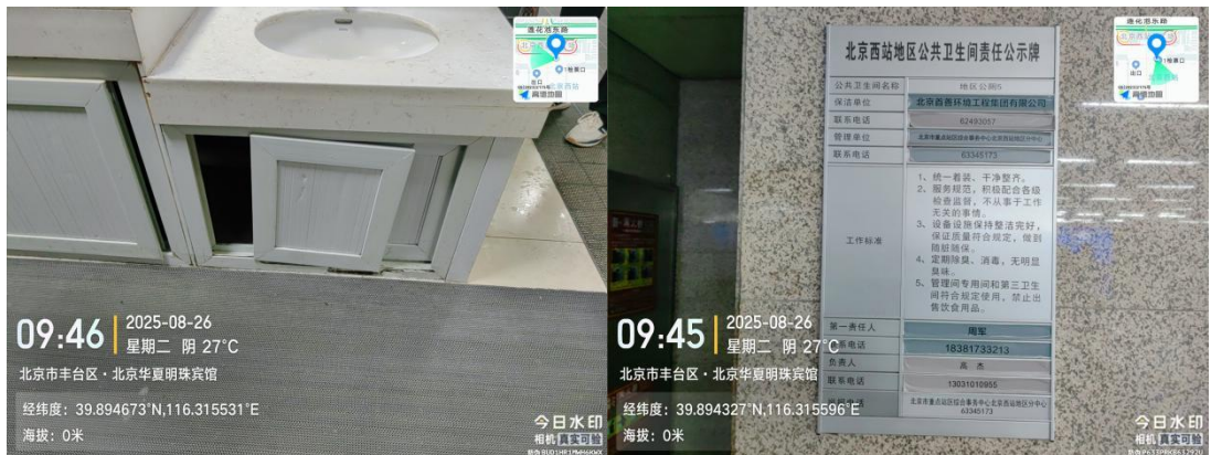
北京西站地区公厕 6(厕内洗手台破损)T09:48
