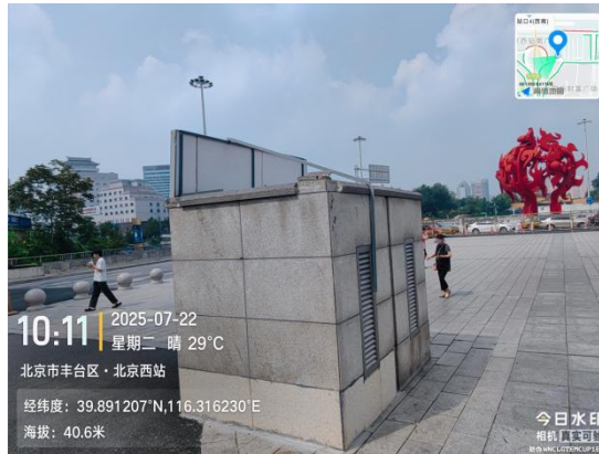
北京西站南广场下沉广场(设施破损)T10:19
