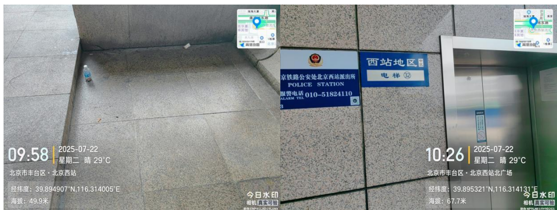
北京西站南广场东南角(通风装置上方破损建材乱堆乱放)T10:11
