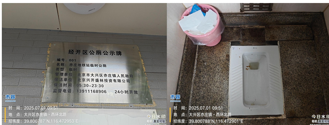
亦庄地铁站临时公厕(大便器内有积存物)T09:51
