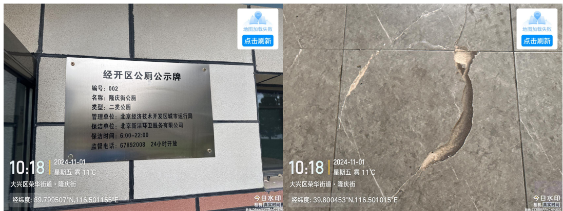
隆庆街公厕(地面瓷砖破损)T10:18
