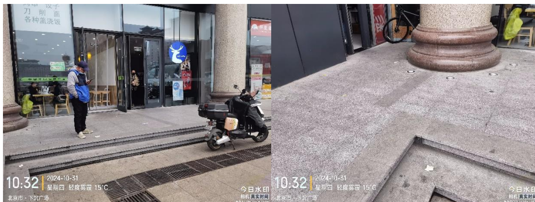
北京西站北广场下沉广场(扶梯下部空间有衣物晾晒和杂物堆放) T10:37
