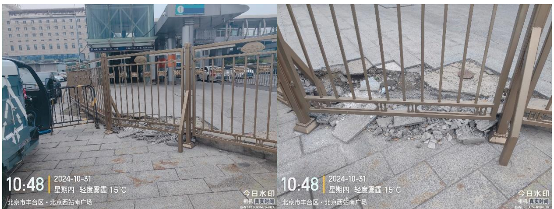
北京西站南广场(6号步梯西侧地面有废弃物)T10:53
