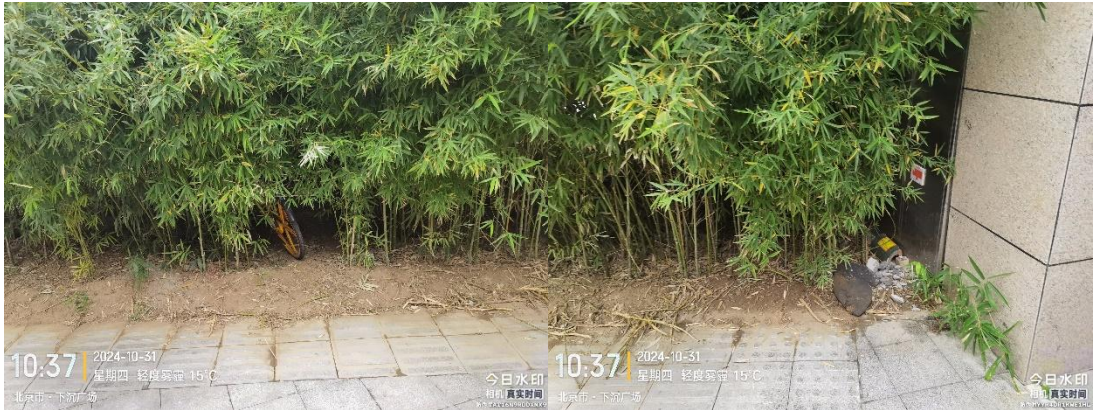
北京西站南广场(东南角人员接驳区地面破损)T10:48
