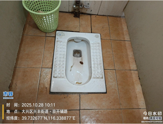
老油库公厕(大便器内有积粪)T10:11
