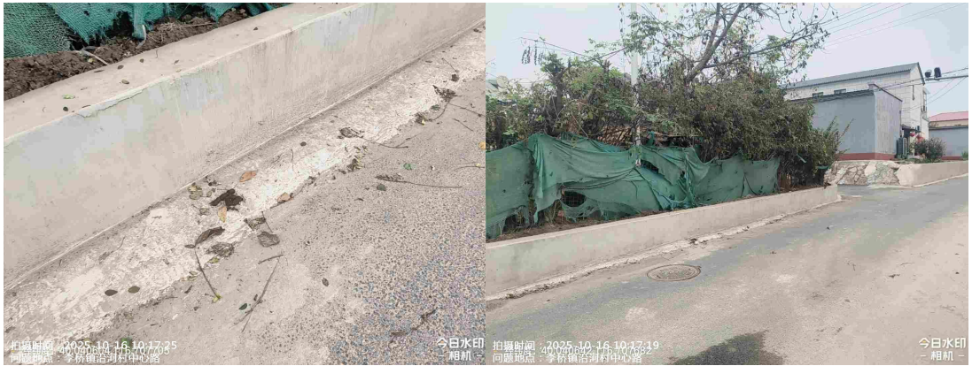
芦各庄村村委会门前路(沟渠内有废弃物)T09:54
