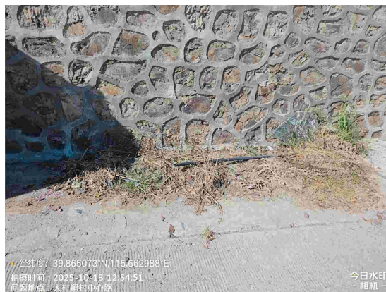
青土涧村中心路(路面有废弃物)T12:08
