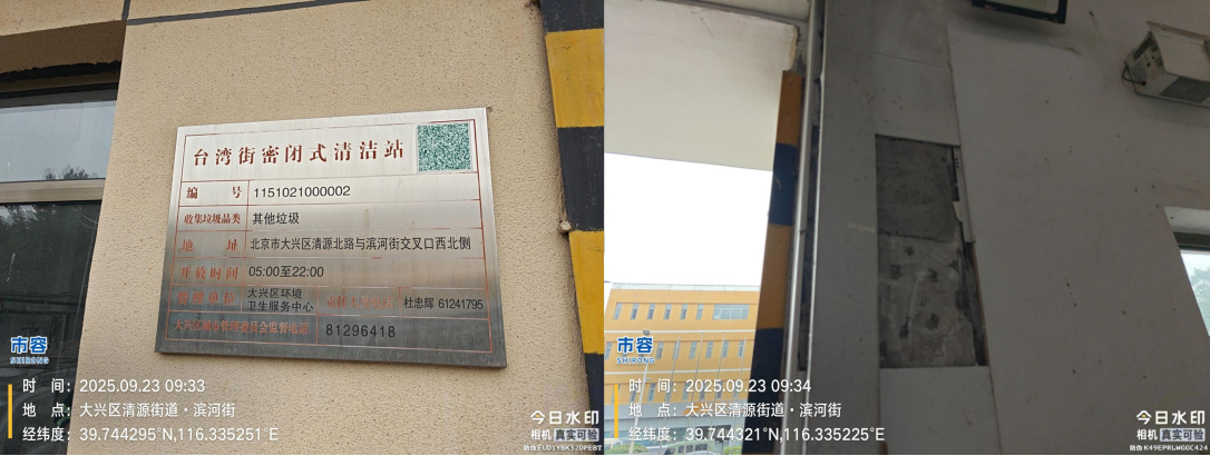
清源西里密闭式清洁站(站内墙皮脱落)T09:53
