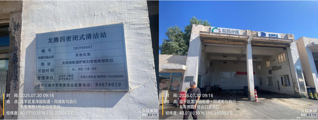
体委垃圾中转站(站内墙皮脱落)T10:20
