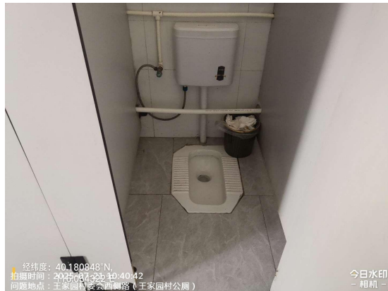
北庄村公厕(扶手锈蚀)T10:32
