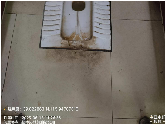
檀木港村三队场公厕(内墙面不洁)T11:37
