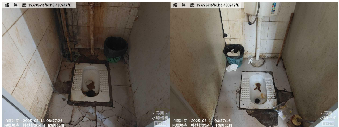
韩村村委会门口西侧公厕(地砖破损)T08:57
