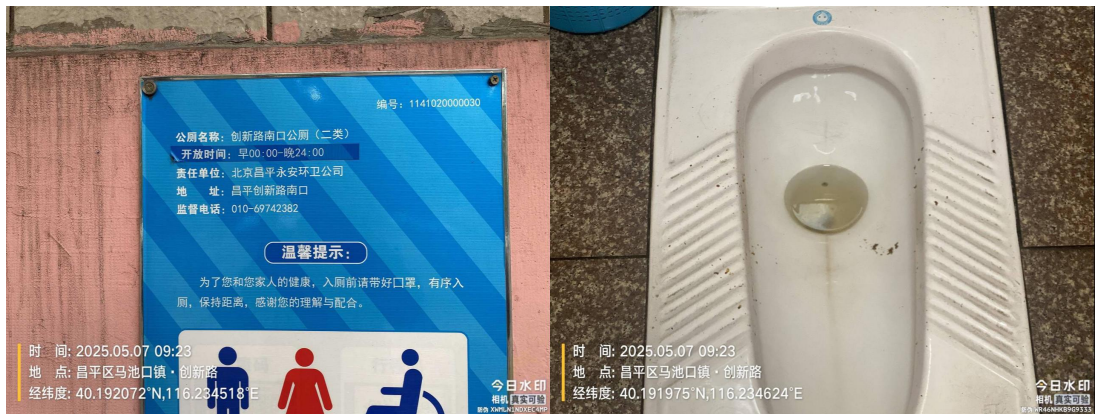
西关环岛公厕(管理间墙皮脱落)T10:23
