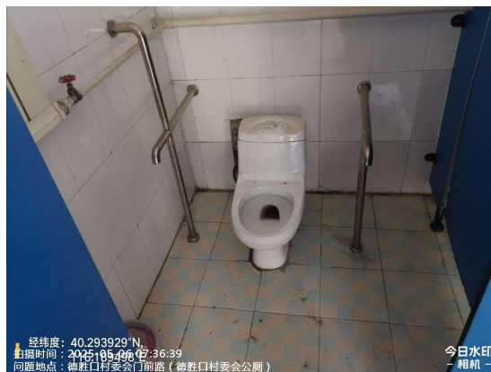
德胜口村委会公厕(坐便器破损)T07:36
