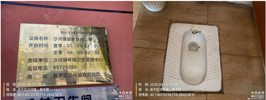
沙河镇政府路西公厕(便器蹲台不洁)T10:09
