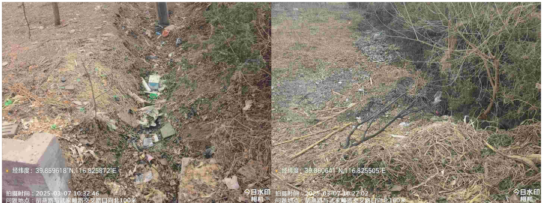
小东各庄村村委会门前路(沟渠内有废弃物)T08:37
