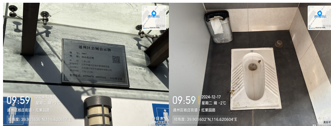
西站北公厕(大便器内有积存物)T09:59
