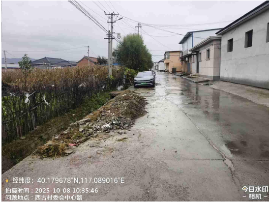
西古村中心路(路面有废弃物)T10:35
