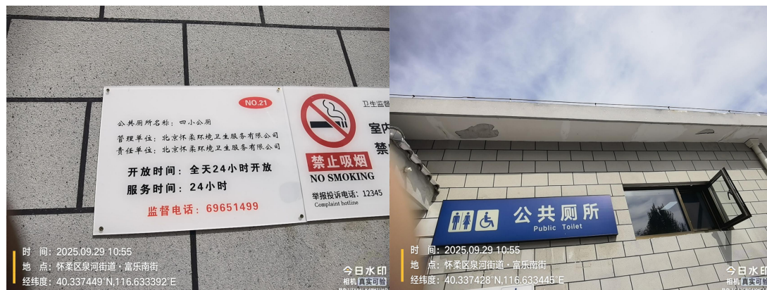
四小公厕(外墙皮脱落)T10:55
