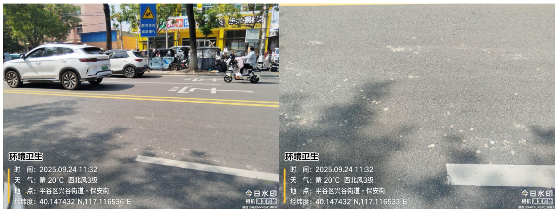
保安街(路面有泥饼)T11:32
