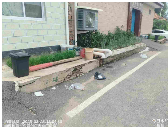
东鹿角村委会门前路(路面有废弃物)T15:04
