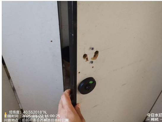
古城村公厕(便器破损)T10:33
