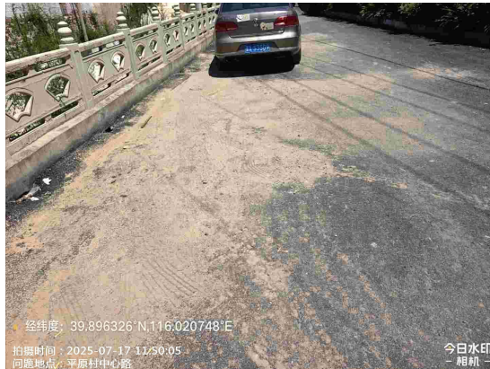
桑峪村村委会门前路(路面堆放建筑垃圾)T12:28
