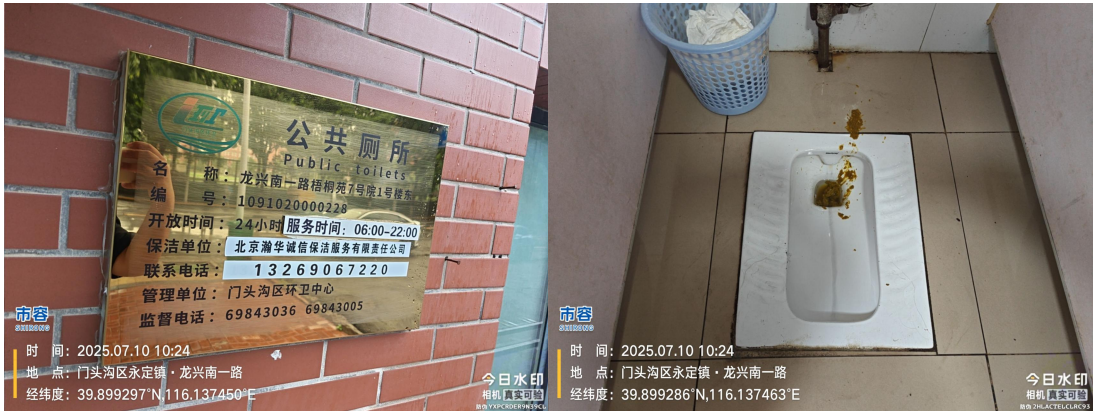
龙兴南一路梧桐苑7号院1号楼东(大便器内有积粪)T10:24
