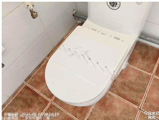
二条街村委会公厕(坐便器破损)T08:59
