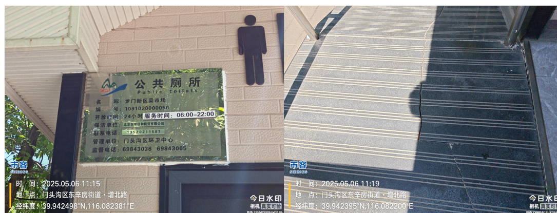
龙门新区菜市场(残疾坡道地面破损)T11:15
