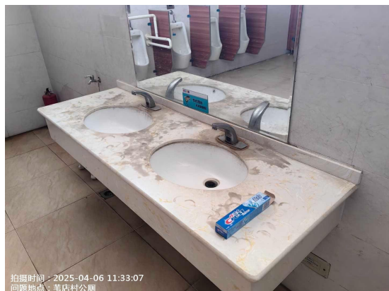
马道峪村公厕(洗手池台面不洁)T11:21
