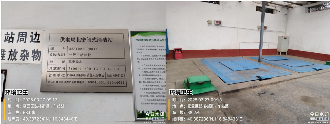
供电局北垃圾房(站内地面有污渍)T09:13
