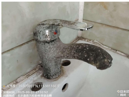
王平镇东王平村石渣坨公厕(水龙头锈蚀)T17:32
