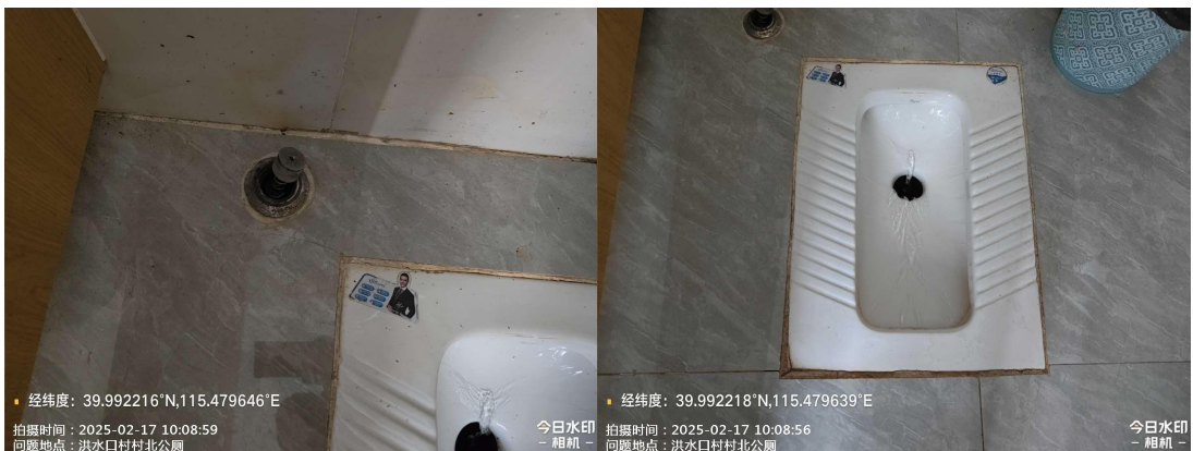
洪水口村北公厕(冲水开关破损水流不停)T10:08
