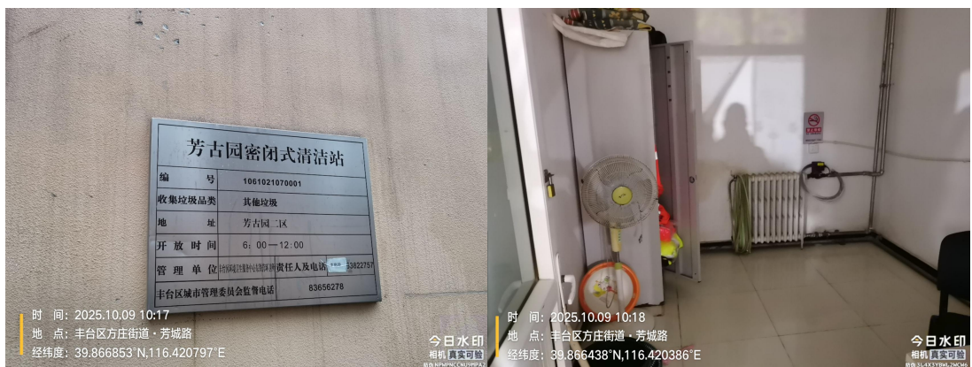
横一条密闭式清洁站(外墙皮脱落)T10:40
