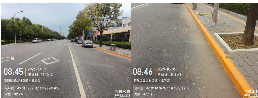
奥林西路(非机动车道边线有浮土)T08:45
