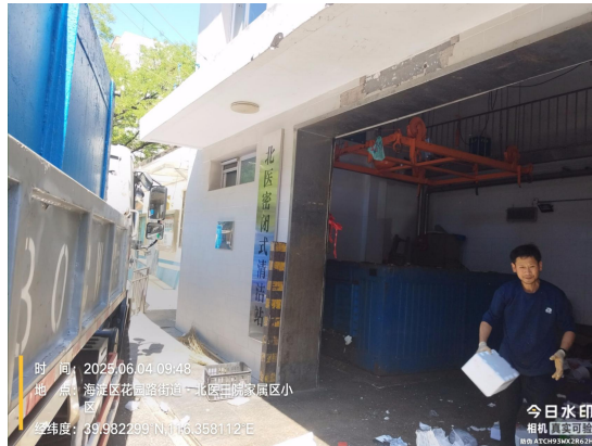
北医密闭式清洁站(站内垃圾箱表面脏污和箱体锈蚀) T09: 48
