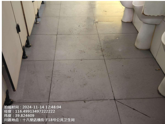
横街子村委会旁公厕(地面瓷砖破损)T12:37
