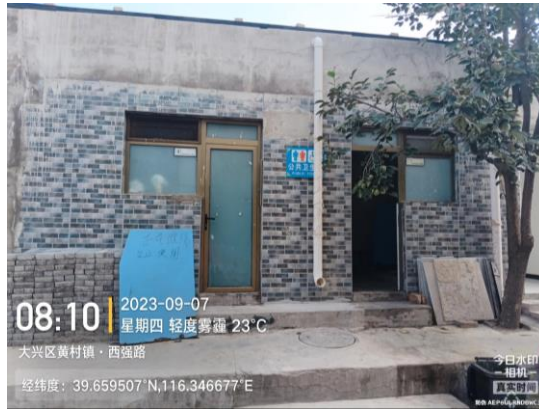
西庄老年活动站公厕（未配备有效的消防器材、厕外地面有废弃物 T08:17）
