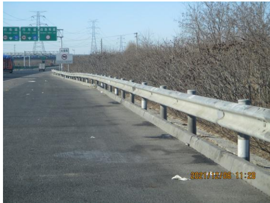
京礼高速出京方向<土城村西桥-小大路>（昌平段：5公里处护坡有废弃物 T11:05/11.5公里处护坡有废弃物 T11:12）
