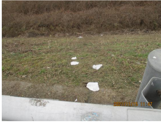
机场第二高速出京方向<平房桥-T3 航站楼> (朝阳段: 0.8公里处路面有浮土杂物 T9:28, T9:30)
