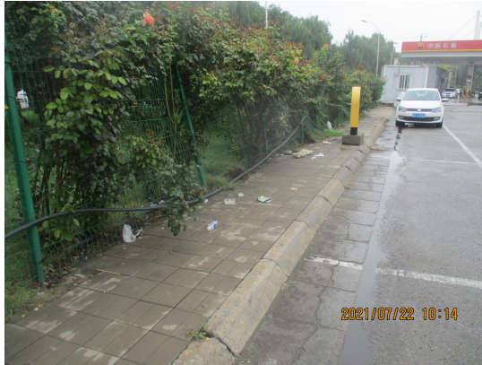
京平高速出京方向<黄港收费站-夏各庄收费站> (顺义段: 13.6 公里处路面有废弃物 T8:50)
