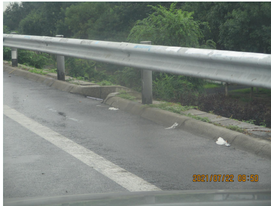
京平高速进京方向<夏各庄收费站-黄港收费站> (平谷段: 65.3 公里处路面有废弃物 T9:39)
