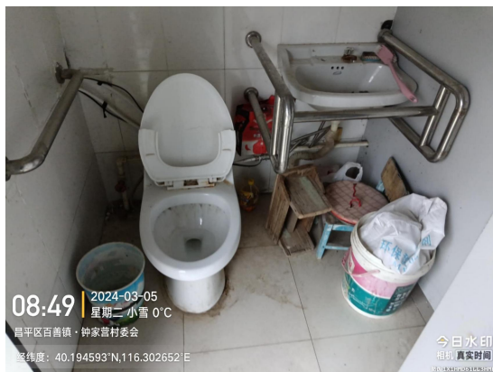
泥洼村西公厕(无障碍卫生间未正常开放)T08:57
