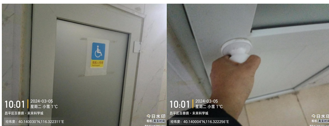
下东廓村委会内公厕(洗手池内有明显锈渍)T10:01
