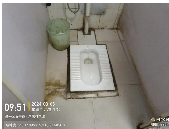
下东廓村委会内公厕(无障碍卫生间未正常开放)T10:01
