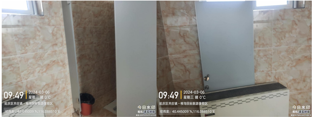
柳沟村村南公厕(厕位门损坏)T09:49
