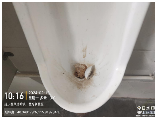
里炮村小区西公厕(公厕内地面不洁)T10:22
