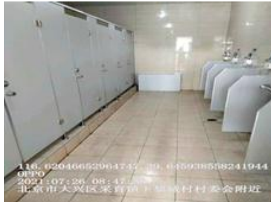
采育镇岳街村东南侧公厕（公厕内未配置灭火器）T9:20
