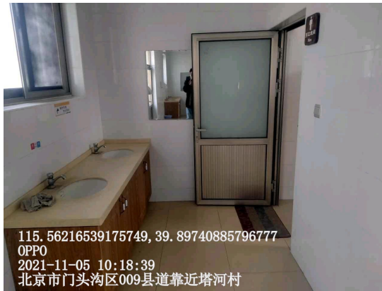
清水镇双塘涧村清水双塘涧口公厕（现场检查未见灭火器）
