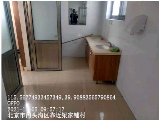
清水镇塔河村公厕（现场检查未见灭火器）T10:18
